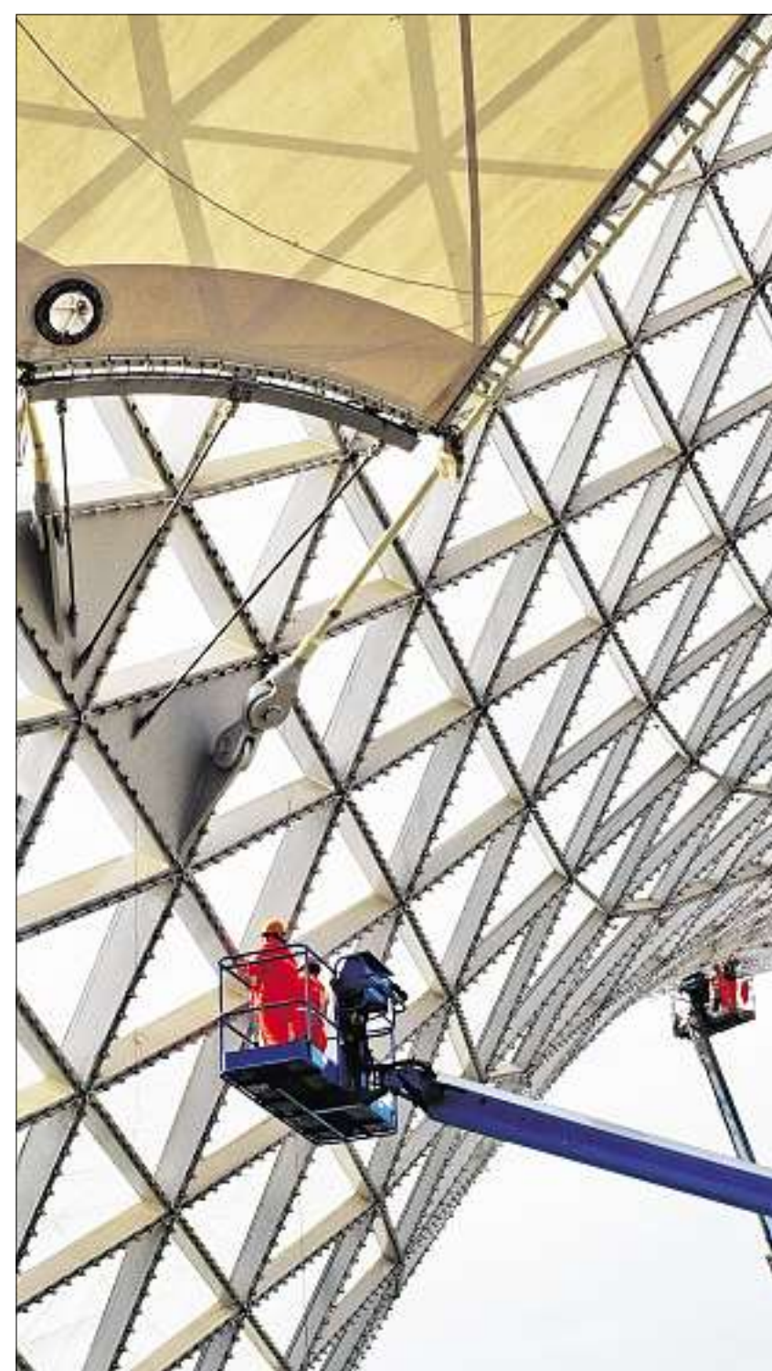
„Sun Valleys“ nennen die Tragwerksplaner ihre Stahl-Glas-Netzschalen, die Licht in die tiefer gelegenen Geschosse des Expo-Boulevards leiten. Das Tragwerk besteht aus vor Ort geschweißten Stahlprofilen mit Glasteilen. Foto: Thomas Ott
